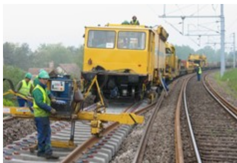
Longs Rails soudés sur traverses béton
