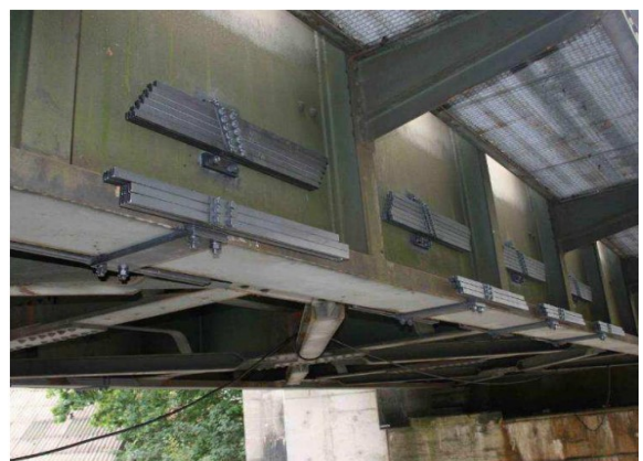
absorbeur sur platelage
